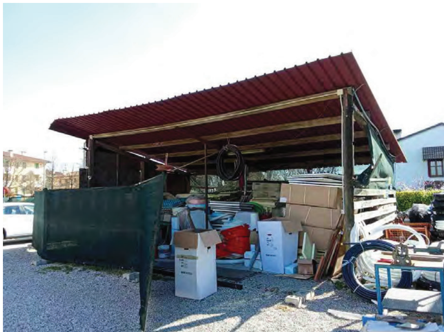
TETTOIA ABUSIVA DA DEMOLIRE
